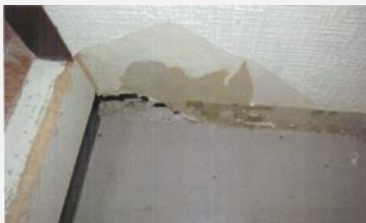
【壁紙はがれ、床面損傷】
