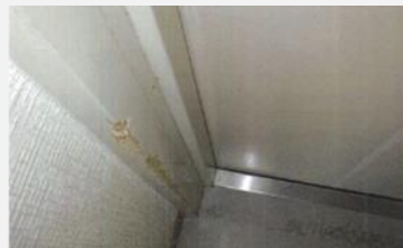
【壁損傷 (ペットによる)】
